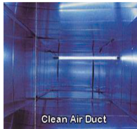
(d) Ultraviolet light bulbs in air duct
